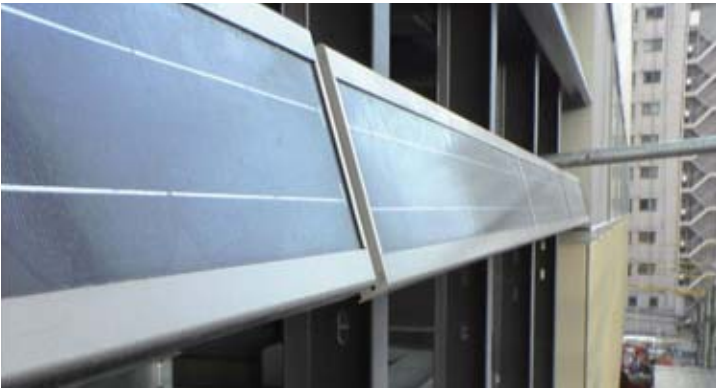
部位：角面ソーラールーバー 合計最大出力：18.04kW
