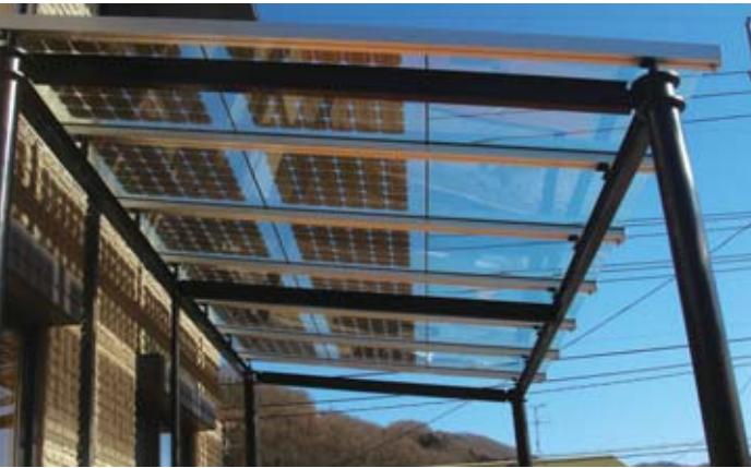
●K 邸(ライトスルータイプ) 設計：旭ビルウォール(株) 部位：テラス ソーラー庇 施工：旭ビルウォール(株) 合計最大出力：5kW
