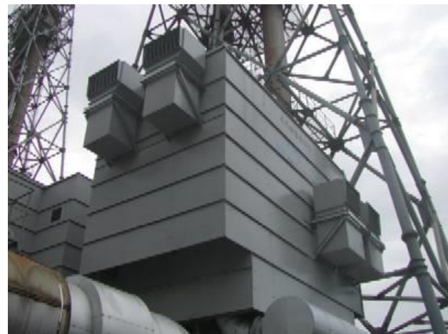
発電所集塵器用防音建屋
