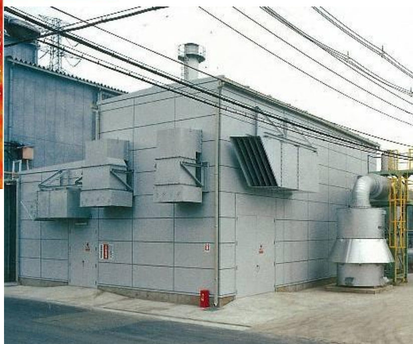
ディーゼル発電設備パッケージ型防音建屋 三菱重工業㈱
